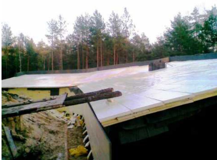
Fot. 3 Specjalna izolacja dachu
