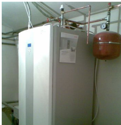
Fot. 6 Zainstalowana pompa ciepła DHP-H 16
