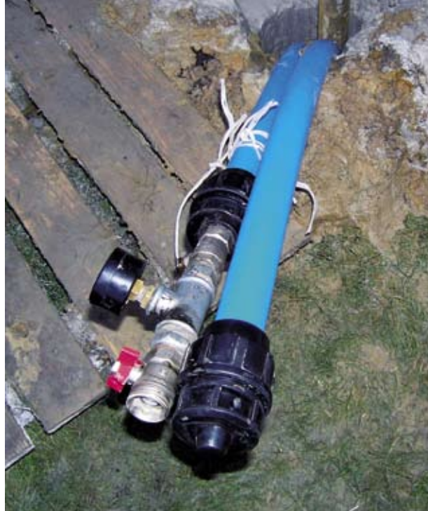
▲ Jeden z odwiertów pionowych z wystającymi końcówkami kolektora pionowego
