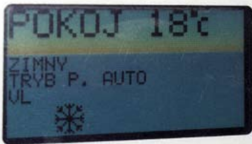
▲ Pompę ciepła DHP-C można wykorzystać jako źródło chłodzenia pasywnego. Wyświetlacz pokazuje, że urządzenie pracuje w takim właśnie trybie
