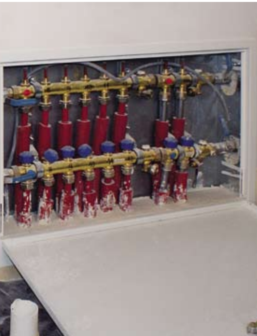
▲ Inwestycja 2 – jedna z dwóch szafek z rozdzielaczami na parterze. Sześć obwodów obsługuje ogrzewanie podłogowe, natomiast dwa grzejniki w łazienkach
