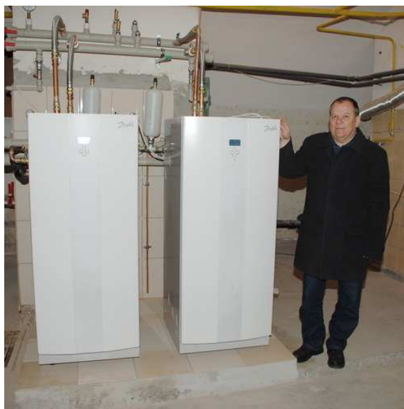
Fot. 4 Karol Sawicz przy pompach ciepła DHP-L 12 kW w zmodernizowanej kotłowni.
